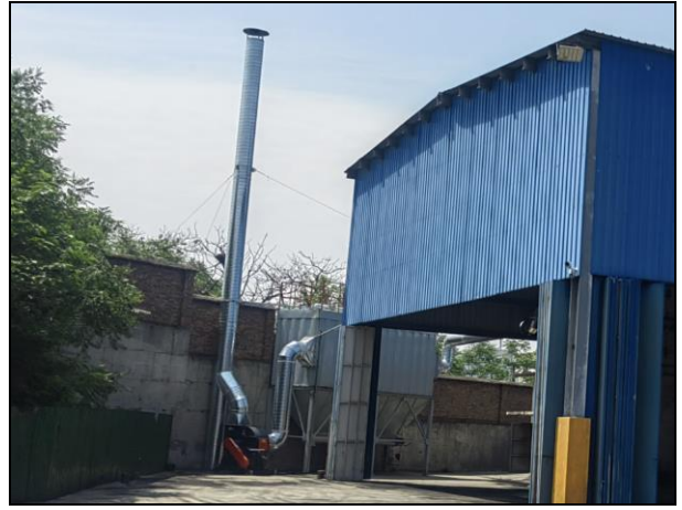
2号受煤坑袋式除尘器
