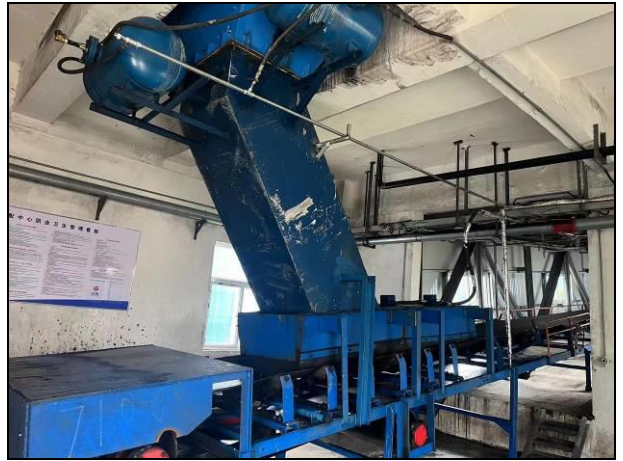
转载站全封闭式导料槽+超声雾化喷淋器
