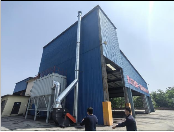
1号受煤坑袋式除尘器
