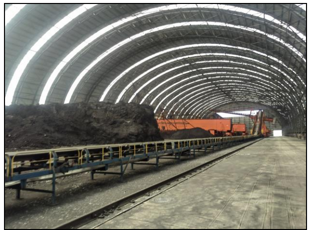
煤炭堆场及顶部喷淋装置
