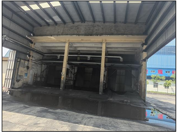
2号受煤坑集气装置
