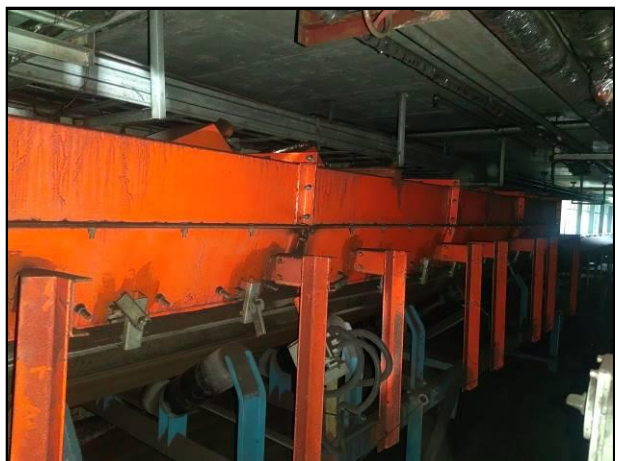
全封闭式导料槽+超声雾化喷淋器
